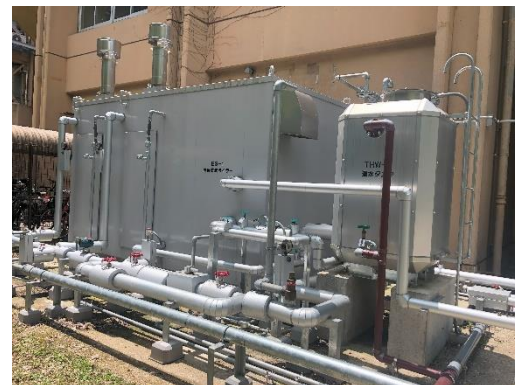
空調熱源用還流ボイラー
