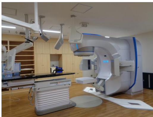
1階リニアック室
