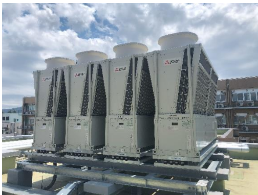
空冷モジュールチラー
