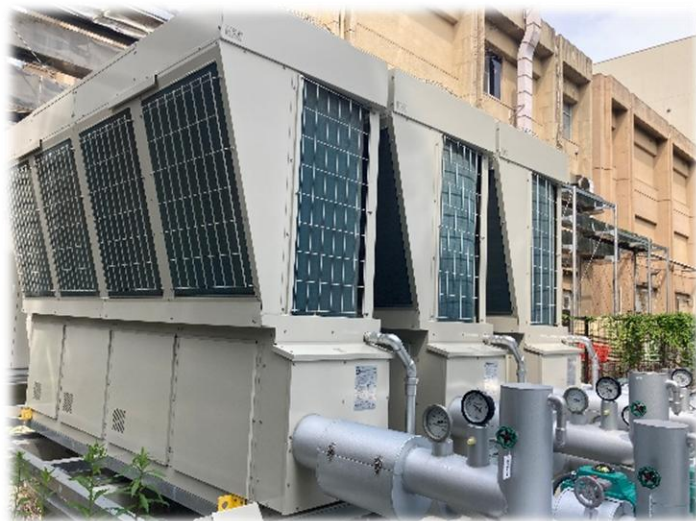
空冷モジュールチラー
