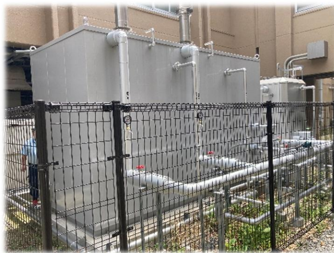
空調熱源用還流ボイラー
